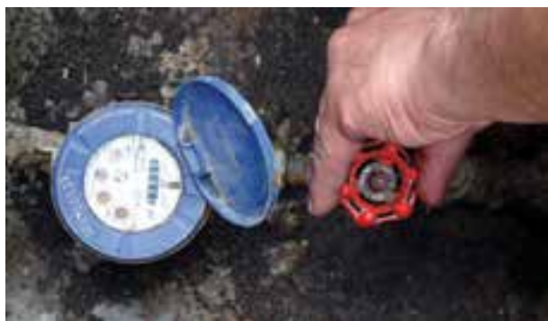
شکل ۱۹۷-۲- بستن شیرفلکه‌ی اصلی
