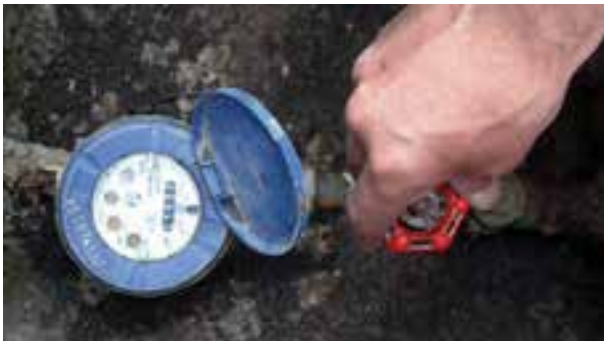
شکل ۲-۱۸۱- بستن شیرفلکه‌ی اصلی
