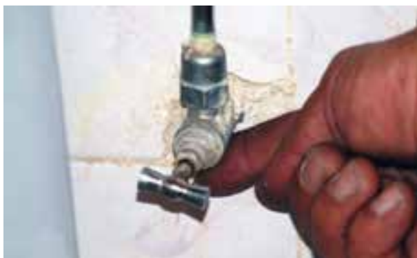
شکل ۱۴۷-۲- کنترل نشت آب از محل اتصال
