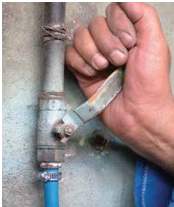
شکل ۱-۱۰۲- شیر قطع و وصل گاز در حال باز شدن
