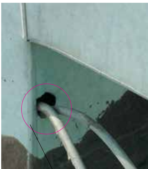
کابل‌کنشی در داخل کانال کولر
