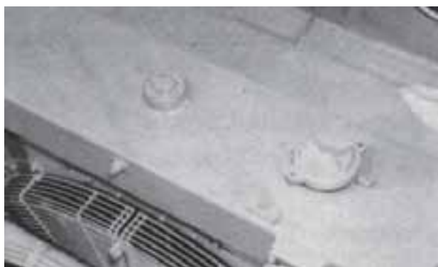
شکل ۹۷-۶ - بازدید سیستم خنک‌کننده از نظر نشستی
