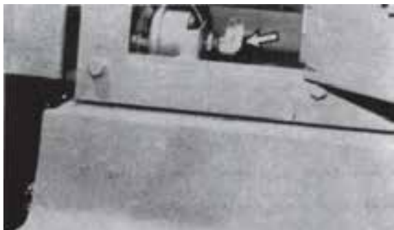
شکل ۵-۶۳ - کلید قطع مدار برق
