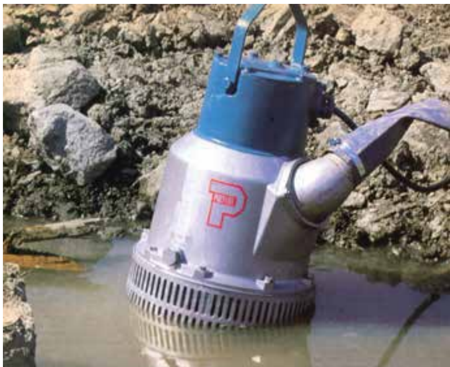
شکل ۱۶-۲- پمپ آبکشی در حال پمپاژ آب سطحی
