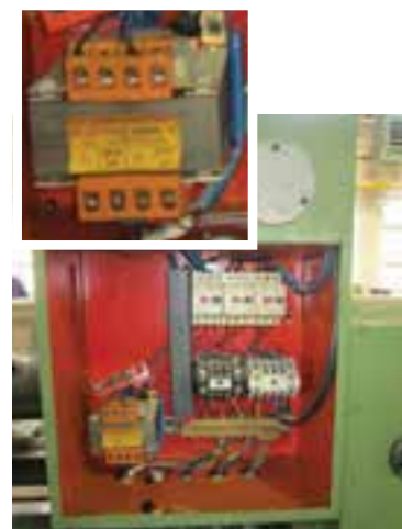
شکل ۴-۱۳ ترانسفورماتور در تابلوی برق دستگاه تراش.
