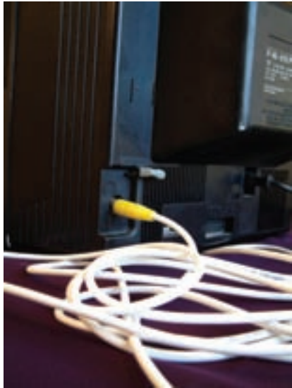
شکل ۱۵-۴ سیم کابل مناسب انتخاب نشده است.
