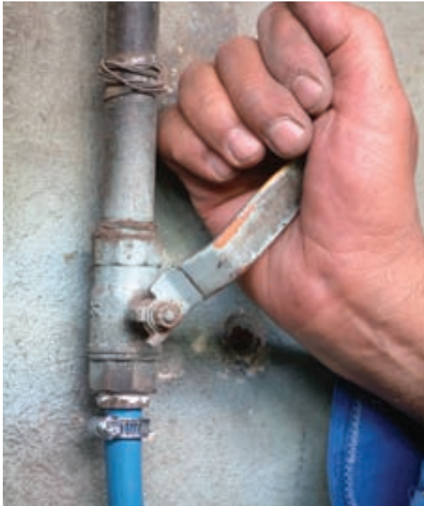
شکل ۱-۱۰۲- شیر قطع و وصل گاز در حال باز شدن
