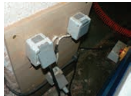
شکل ۲۱۳-۱۶- تابلو برق غیراستاندارد.
