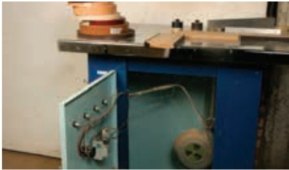
شکل ۱۲۸-۱۶- باز کردن در و کنترل قسمت‌های برقی.
