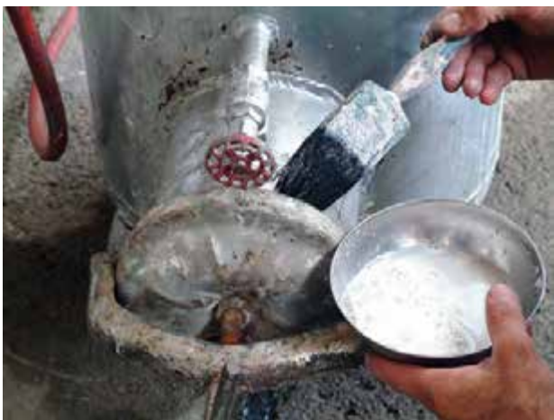
شکل ۲-۳۹- کنترل نشستی گاز
