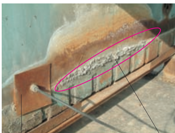
رسوب‌های آب تعمیر غیراساسی شکل ۸-۱۷۶
