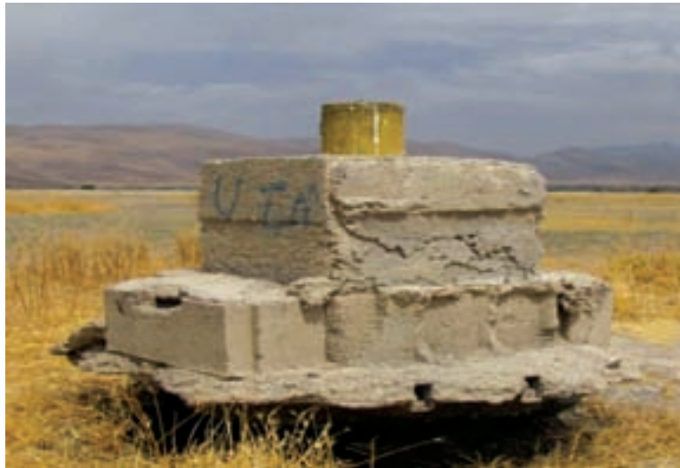
تصویر ۸-۴- پدیده فرونشست زمین (منطقه خانمیرزا)
