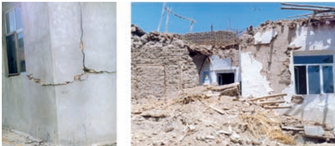
شکل ۳۶-۱- تصاویری از خسارت زلزله اردیبهشت ۱۳۸۱ در دینور
