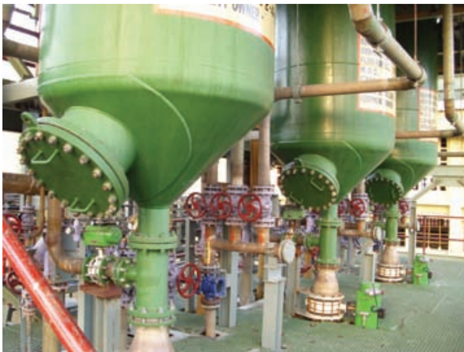
شکل ۴-۳- بخشی از کارخانه کلر آلکالی
