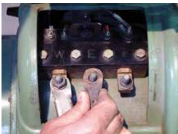
شکل ۱-۴۸- ترمینال E برای آمپرهای زیادتر
